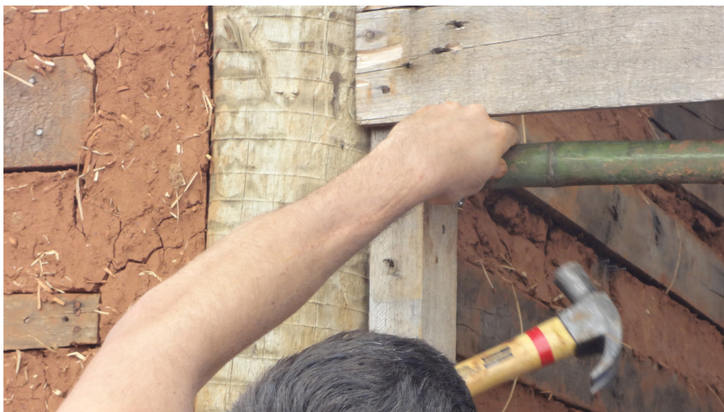
Figura 3 – Pregos sendo fixados entre pallet e bambu, promovendo mais estabilidade na estrutura para receber a trama de bambu. Fonte: Arquivo pessoal (2023).
