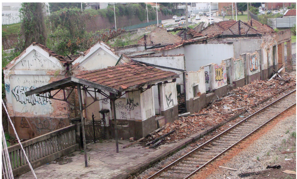
FIGURA 5 – Estação Ferroviária da Instituto do Patrimônio Histórico e Artístico Nacional após incêndio ocorrido em julho de 2018.
