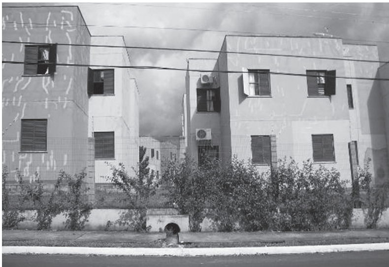
FIGURA 5 – Foto do residencial II e III indicando o local de saída de água pluvial no passeio público, além de rachaduras nas paredes externas dos prédios. Campo Grande (MS).
