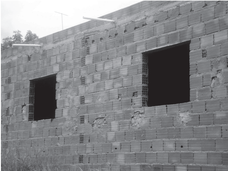
FIGURA 2 — Parede externa — ausência de verga. Região Metropolitana de Belo Horizonte. Fonte: Arquivo pessoal (2008).
