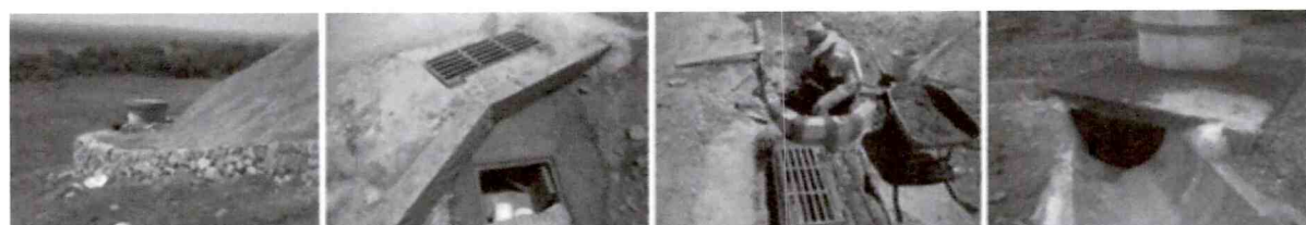
FIGURA 9 – Bocas de lobo. Fotos: Mara Araujo/mar. 2006.
